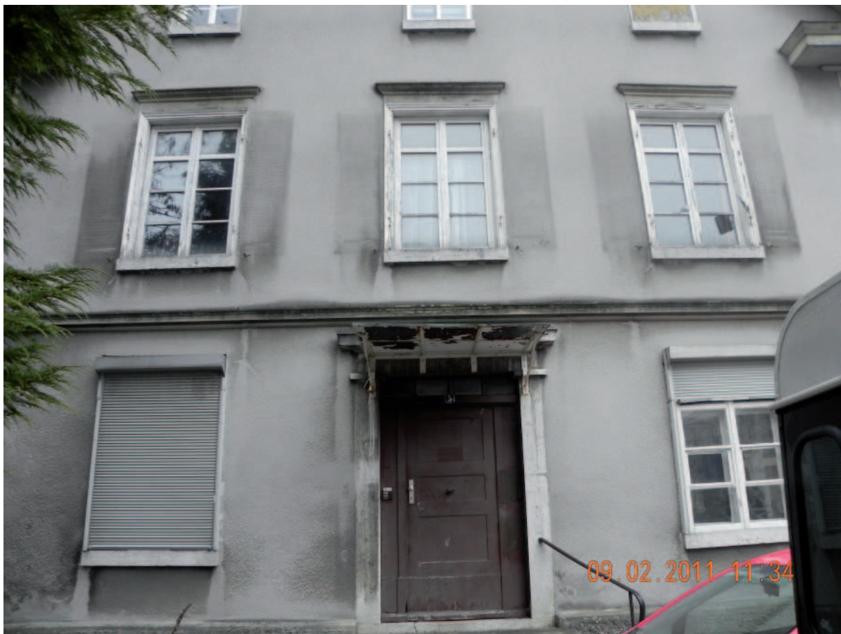
Fenster und Vorfenster waren fast ausnahmslos erhalten und dringend sanierungsbedürftig
